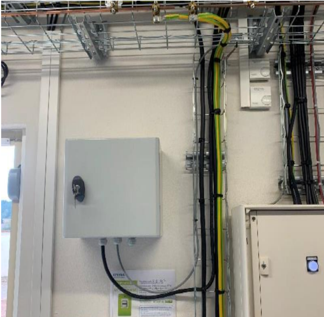
Coffret électrique et télécom
